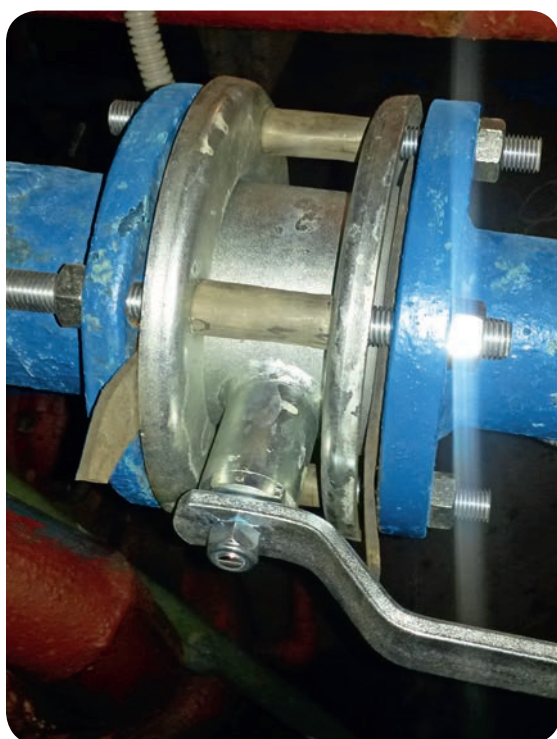
ПОДАЧА В ТЕПЛООБМЕННИК DN 80
