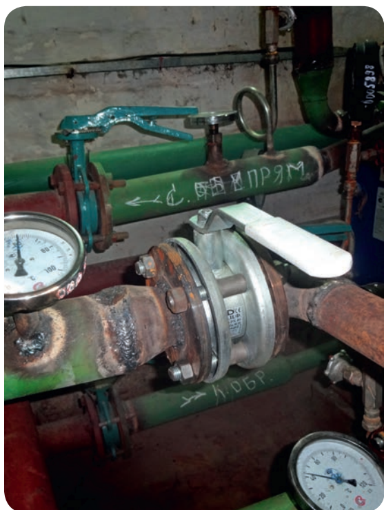
ТЕПЛОПУНКТ (ОБВЯЗКА ТЕПЛООБМЕННИКА)
