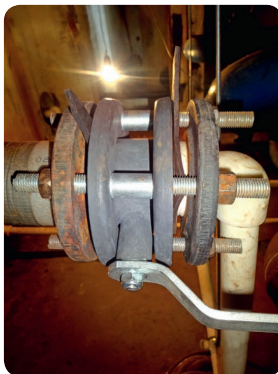
ПОДВАЛ ЖИЛОГО ДОМА (КОНТУР ГВС)
